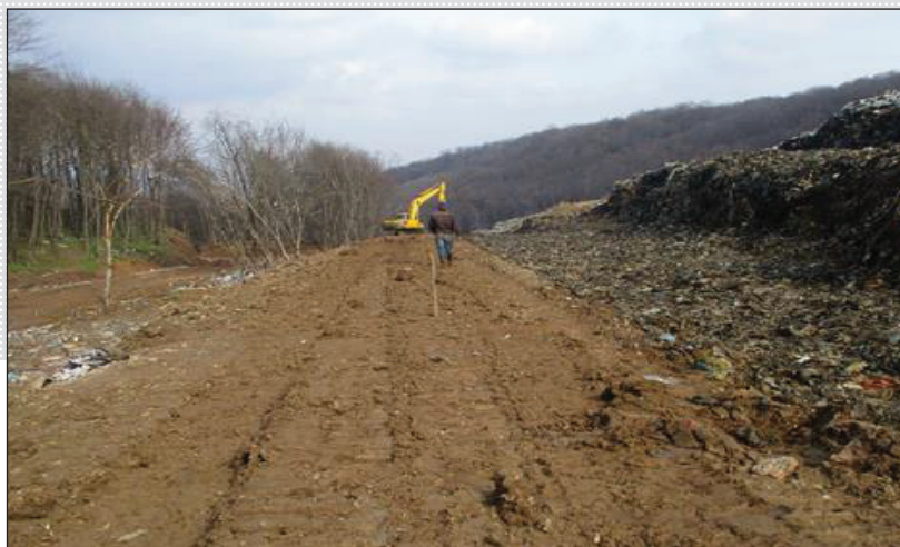
پروژه بهسازی محل دفن موجود شهر رشت
