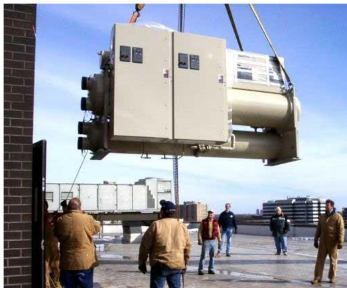
شکل شماره ۲- تصویر یک چیلر جذبی در مرحله نصب
